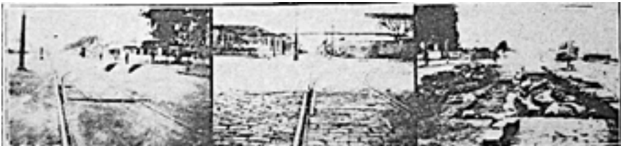
Imagen 20: Tres aspectos de los deterioros ocasionados en las instalaciones de las vías tranviarias. Levantamiento de rieles: Avenida Pellegrini entre Ovidio Lagos y Callao; destrucción de las agujas de los cambios en Moreno y Av. Pellegrini y Av. Pellegrini y Alvear respectivamente. La Capital , Rosario, 14/07/1928.
